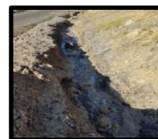
Gambar 4. Kondisi Aktual Saluran Terbuka I
