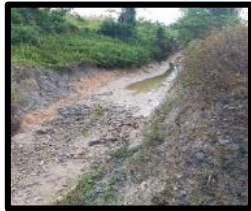
Gambar 6. Kondisi Aktual Saluran Terbuka III
