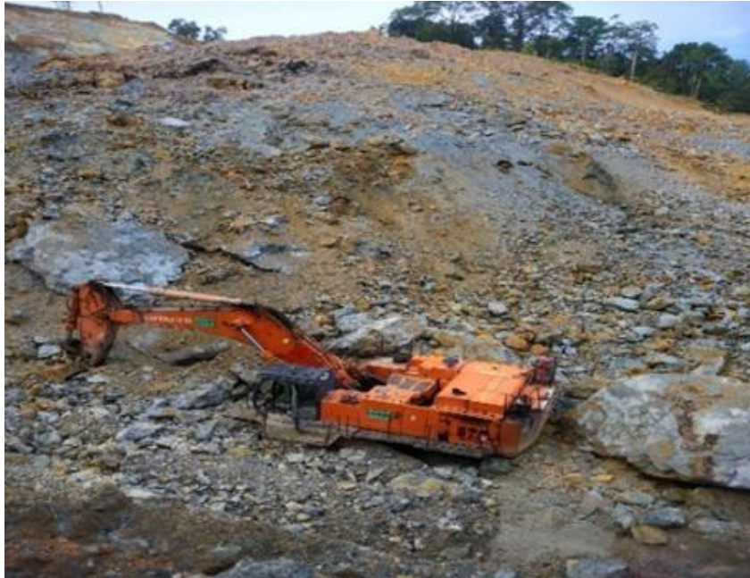
Gambar 4. Insiden di Area Front Loading ( Sumber: Data Primer di Lapangan, 2022 )
